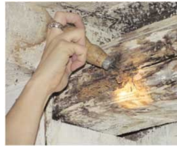
Apodrecimento em viga de madeira ocasionado por fungos
